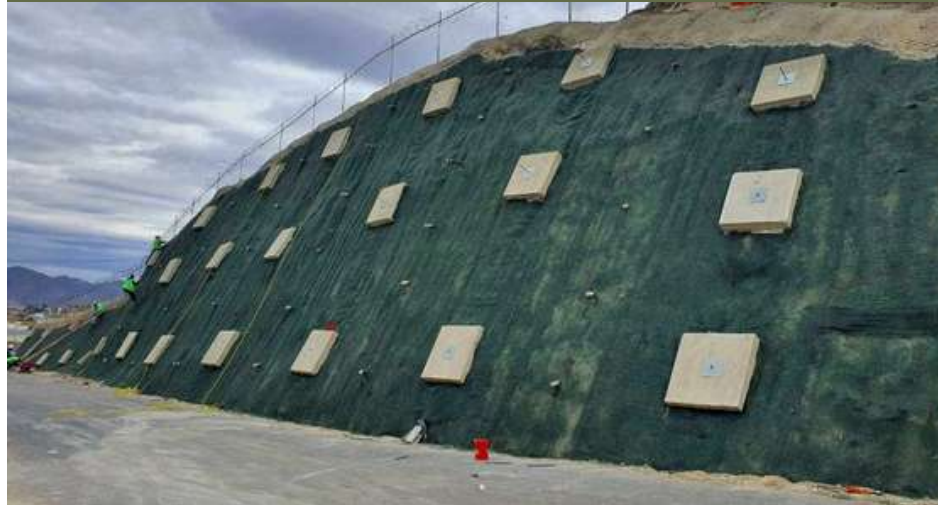
SISTEMA DE CONTROL DE EROSIÓN
